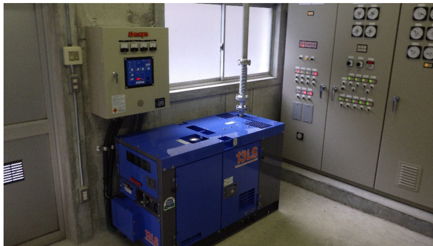
豊邦浄水場内に設置した自家発電設備
